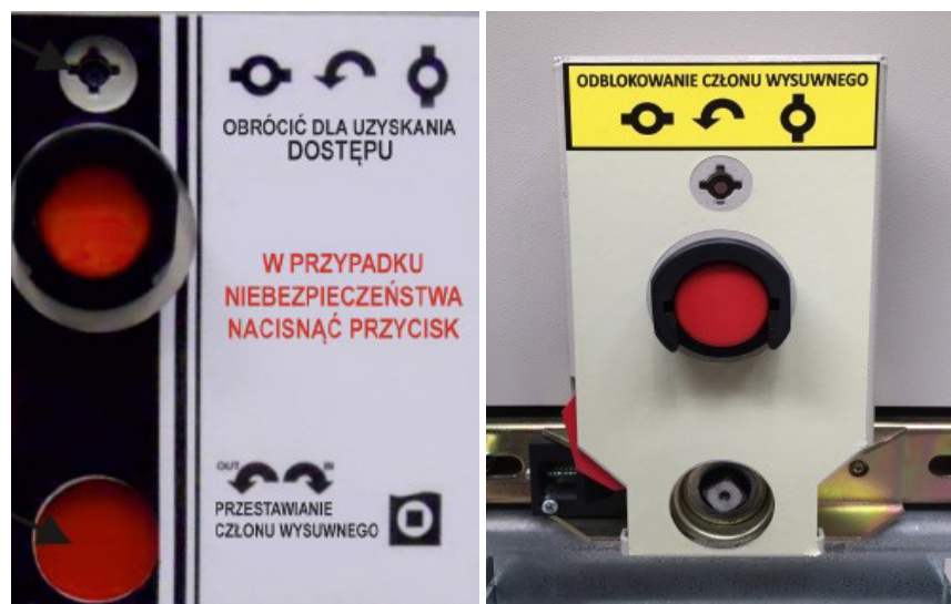
Fot nr 4: Przycisk awaryjnego mechanicznego wyłączenia rozdzielnic MILE oraz na członie wysuwным.
