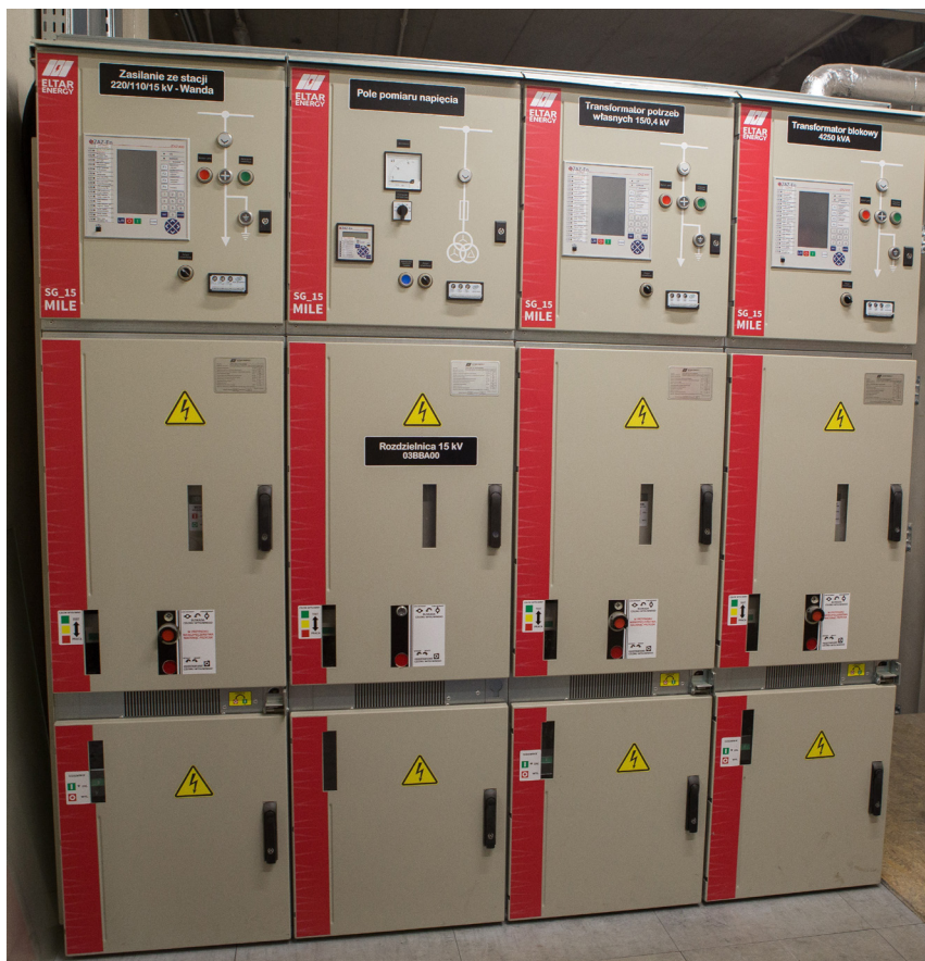
Fot nr 1: Rozdzielnica typu MILE z wyłącznikami z napędem magnetycznym. Porównania obu typów napędów dokonano biorąc pod uwagę różne cechy.
